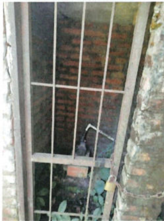
Vista CA-8 Pozo
