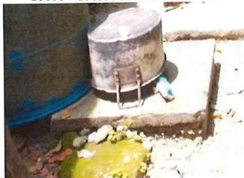
CA17- CAJA DE REGISTRO
